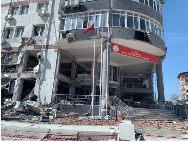
2: Hatay Merkez, Hasarlı kamu binası, 1. Ay Raporundan
